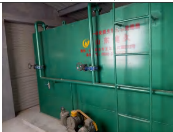
生活污水处理设施
