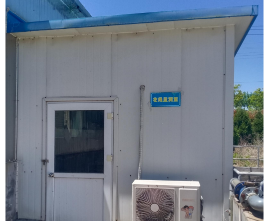
污水处理站在线监测
