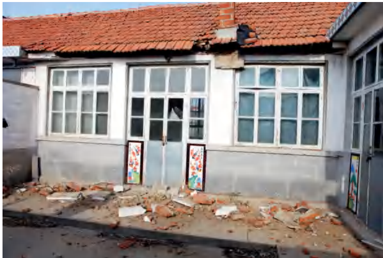
2014年1月7日，乳山市4.3级地震损坏的房屋（辛戈摄）
